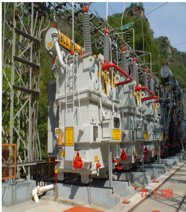
Figura 10. Bancos Sistema Eléctrico.
